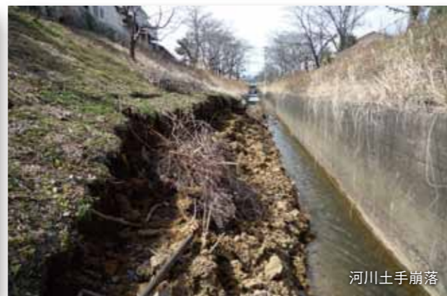
道路・護岸崩落
