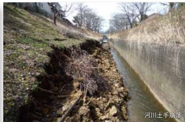
道路・護岸崩落
